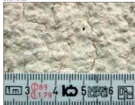
3.2.8 Piccole fessure sottili nell'intonaco sintetico causate da un asciugamento troppo veloce.
