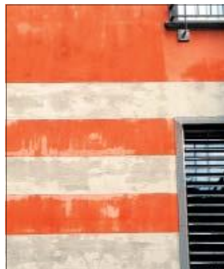
3.2.6 Rasante a base di calce minerale e tinta che presenta un'umidificazione non uniforme dopo un temporale.
