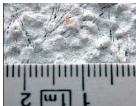
3.2.8 Cause diversi: Fessure nella superficie di intonaco causate dal gelo; disturbo per le caratteristiche dell'intonaco di finitura; alto rischio di infestazione.
