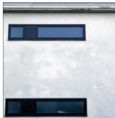
3.2.6 Intonaco ai silicati tintato, su un isolamento termico, che presenta un'umidificazione non uniforme.
